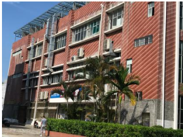
第一食堂排烟管道
