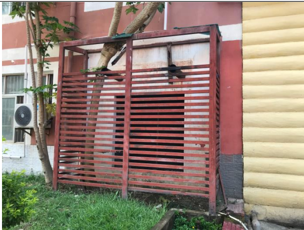
石油大楼东侧发电机房排烟口 110°24'15.69963",20°2'41.17054"
