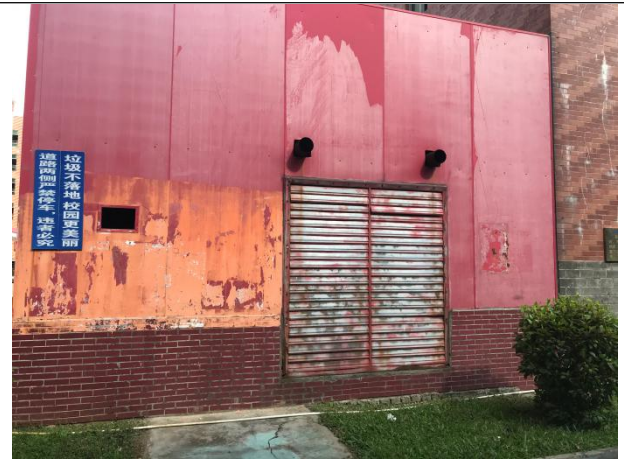
第一食堂对面发电机房排烟口 110°24'18.04603",20°2'45.01361"
