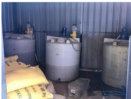
1 号污水处理站 110°24'22.54570",20°2'37.34678"
